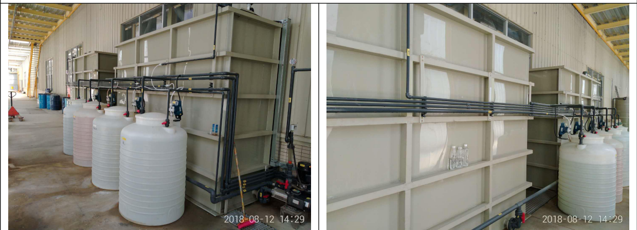
清洗废水处理设施
