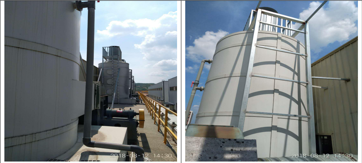
项目废气处理设施
