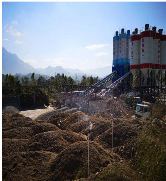
材料仓水喷淋设施
