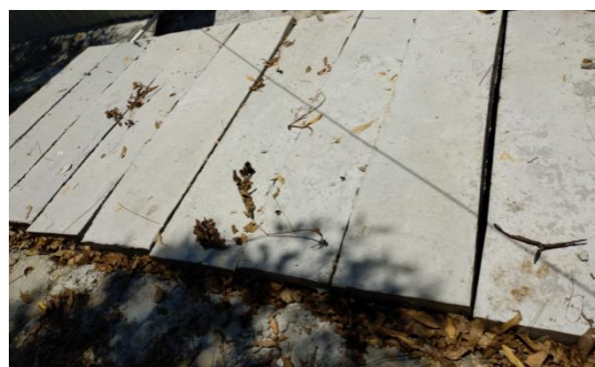
隔油池及化粪池
