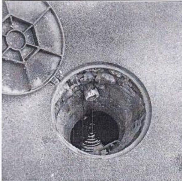
照片 1: 三级化粪池
