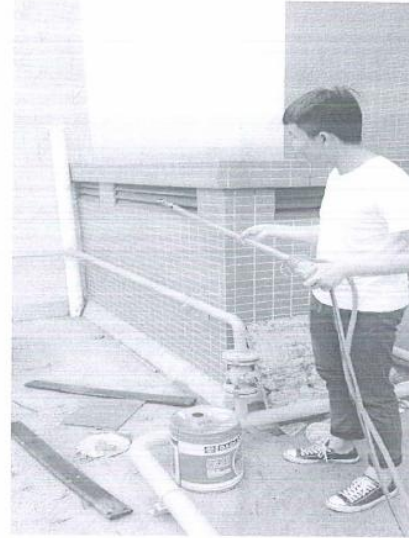
发电机废气排放口:
