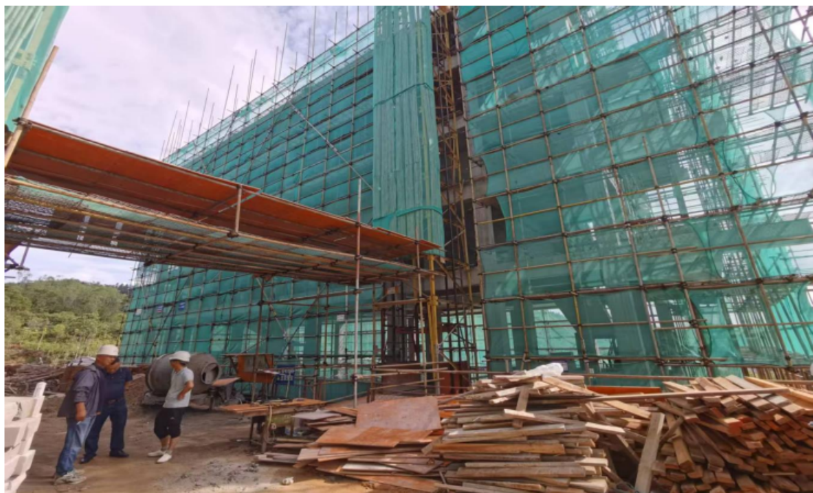
图 3 2#楼物料提升机 1 楼入料口图
