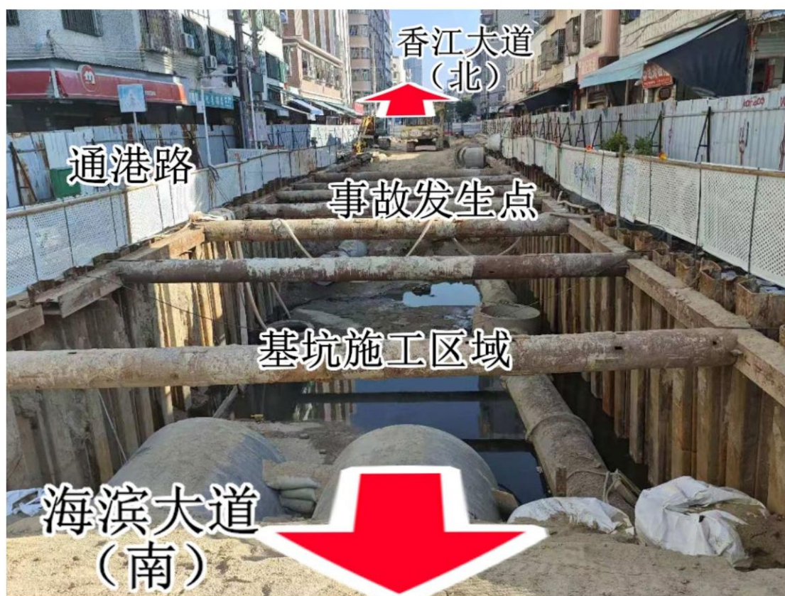
图1 事故现场照片
