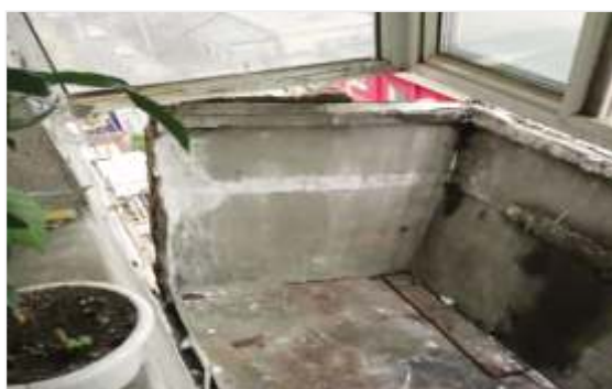
悬挑阳台开裂、大变形
