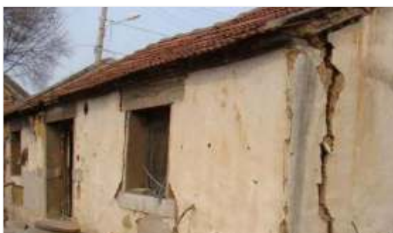
现象：生土墙存在竖向开裂，裂缝宽度大 判断：存在安全隐患
