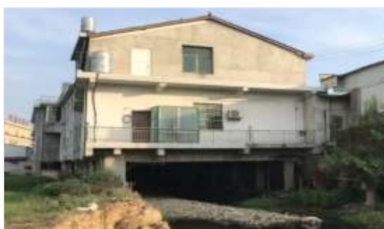
现象：河道上建设房屋 判断：存在安全隐患
