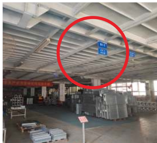
现象：在楼层中违规增设夹层 判断：存在安全隐患
