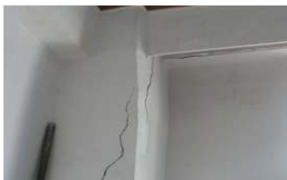
柱构件纵向顺筋裂缝,可能为钢筋锈胀引起
