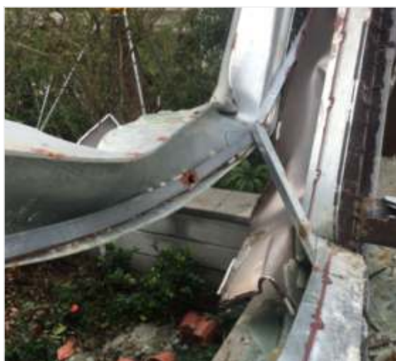
现象：钢构件弯曲变形、扭曲变形、局部变形 判断：存在安全隐患
