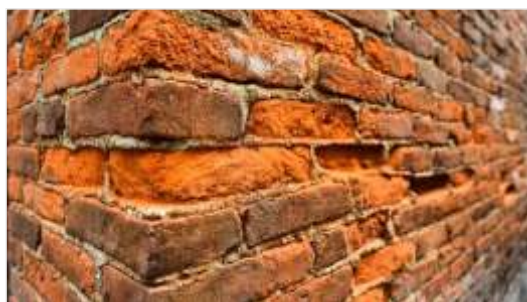
现象:红砖承重墙严重风化 判断:存在安全隐患
