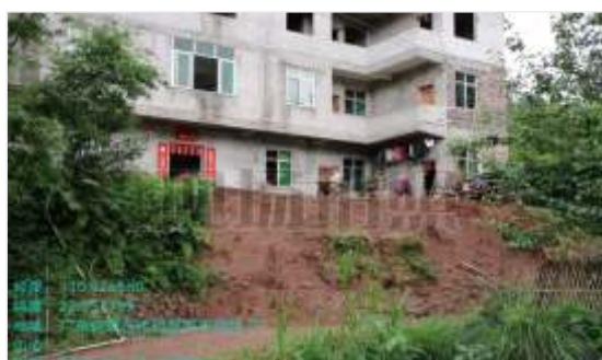
现象：场地雨后发生滑坡 判断：存在安全隐患
