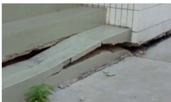
现象：地基基础下陷引起室外地坪开裂 判断：存在安全隐患
