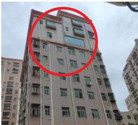
现象：顶部立面风格有明显差异 判断：存在安全隐患
