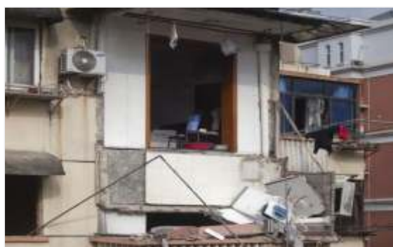
悬挑阳台坍塌
