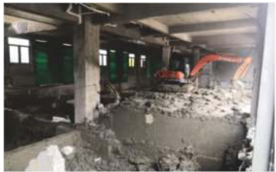
私自开挖地下室
