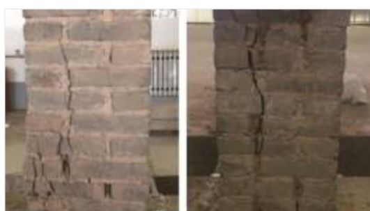
现象:砖墙砖柱有多道竖向裂缝 判断:存在安全隐患
