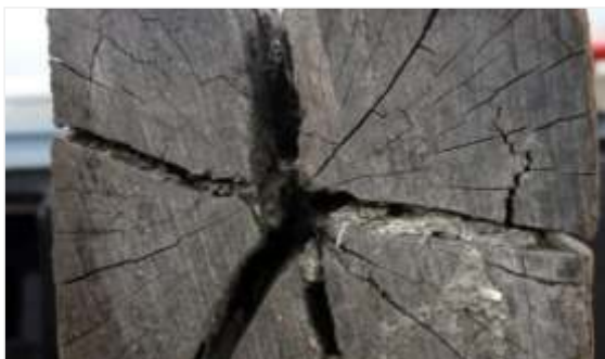
现象：木构件材料存在严重开裂 判断：存在安全隐患
