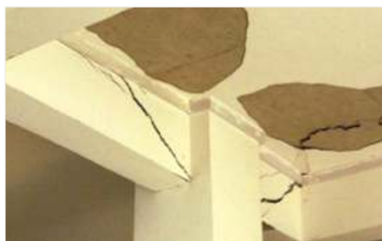
梁构件端部斜向裂缝
