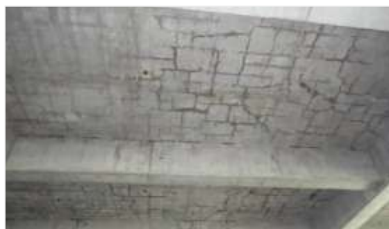
现象：混凝土楼板无规则龟裂，裂缝贯穿 判断：尚不属于安全隐患
