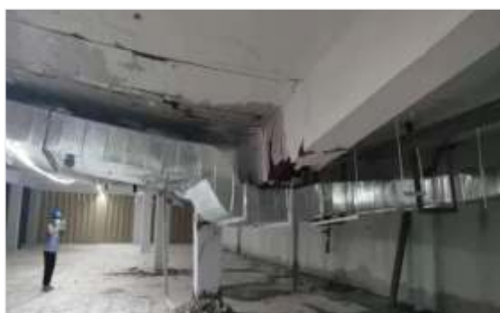
混凝土梁下挠
