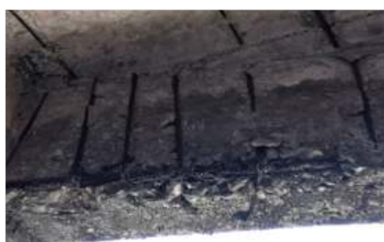
梁钢筋锈蚀、保护层脱落
