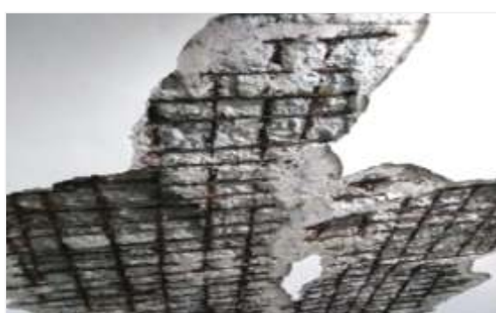
板钢筋锈蚀、保护层脱落
