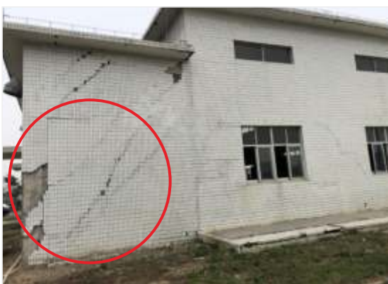
沉降不均匀引起房屋开裂
