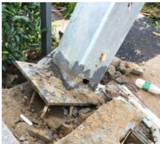
现象：钢柱与基础连接松动、或脱开 判断：存在安全隐患
