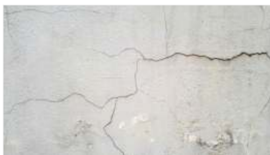
现象:房屋墙体无规则龟裂,裂缝未贯穿 判断:不属于安全隐患
