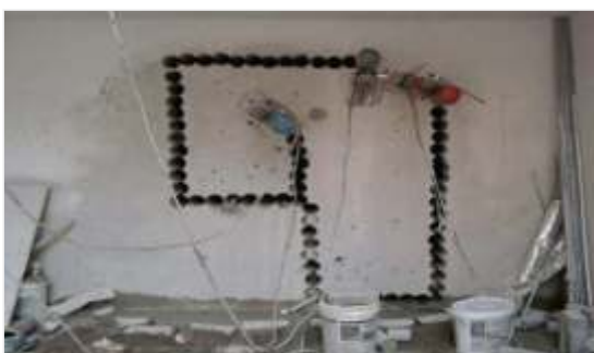
现象:违规在混凝土承重墙上开洞口 判断:存在安全隐患
