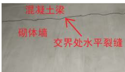
现象:混凝土梁与砖墙交界处存在水平裂缝 判断:不属于安全隐患
