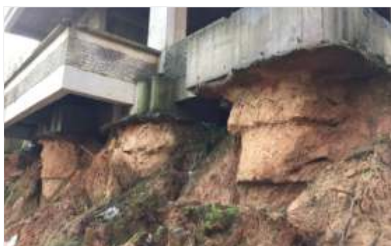
临近未加固的高坡
