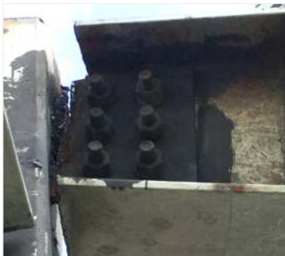
现象：钢结构构件连接开裂、甚至断开 判断：存在安全隐患
