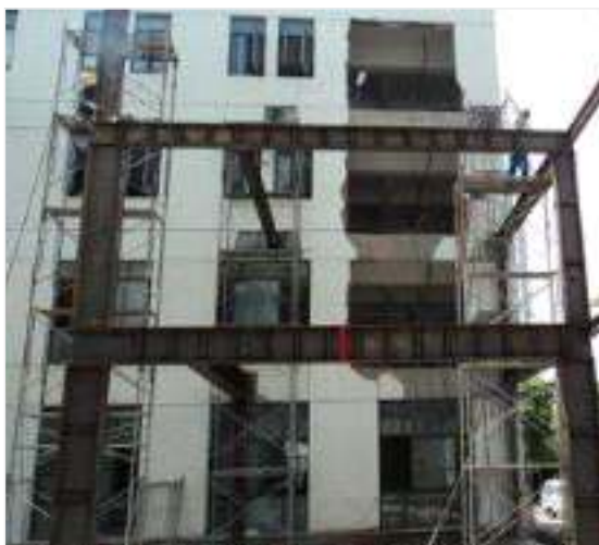
现象：违规在既有建筑物平面外搭建钢结构 判断：存在安全隐患
