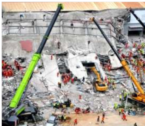
2020年3月7日, 福建省泉州市欣佳酒店倒塌; 事故原因为长期违法违规建设、改建和加固施工、使用虚假鉴定报告作为证明文件
