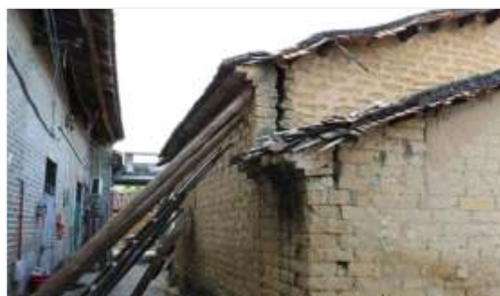
现象：泥砖墙明显歪闪、外倾，严重开裂 判断：存在安全隐患
