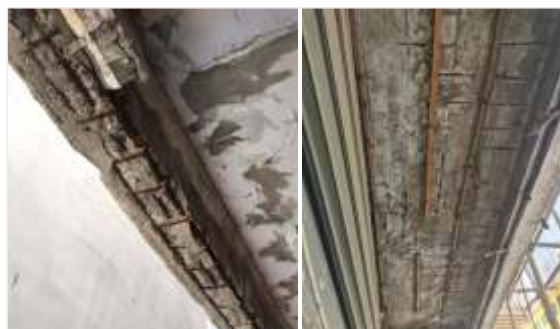
现象：混凝土梁、板钢筋锈蚀、保护层脱落 判断：存在安全隐患
