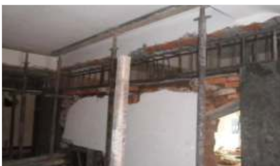
现象:违规墙改梁,拆改承重墙、增设混凝土梁 判断:存在安全隐患
