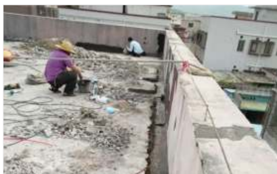
女儿墙开裂外倾
