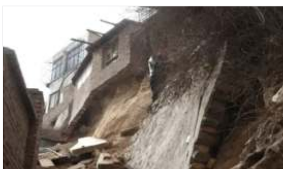
现象：房屋建在高边坡上，有滑动迹象 判断：存在安全隐患
