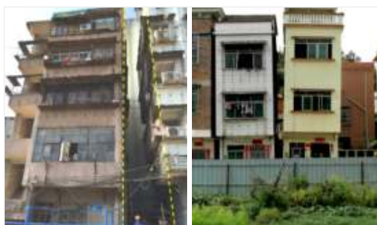
现象：房屋整体或局部倾斜 判断：存在安全隐患
