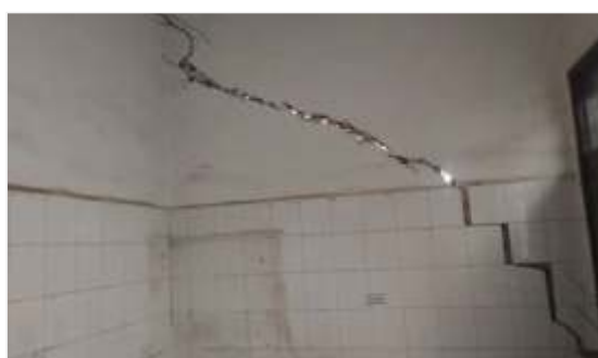
现象：地基不均匀沉降引起墙体斜向开裂 判断：存在安全隐患
