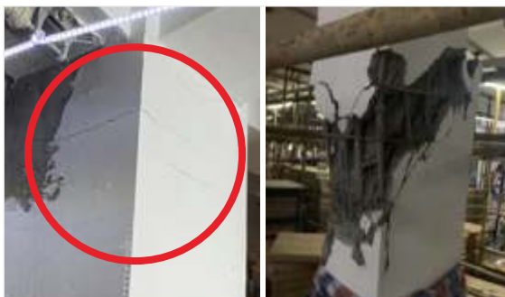
现象：柱端横向裂缝、斜裂缝 判断：存在安全隐患
