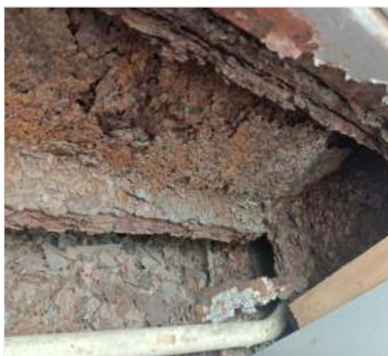
现象：型钢构件严重锈蚀、锈蚀层可剥落 判断：存在安全隐患
