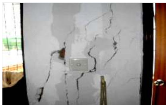
砖墙竖向开裂
