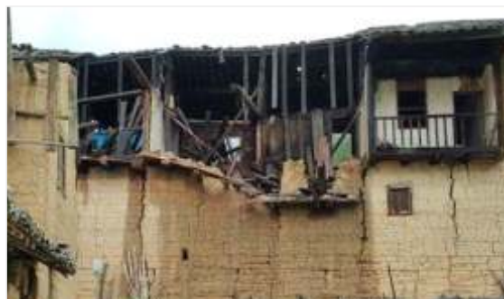
现象：木瓦屋盖局部坍塌，生土墙受潮局部坍塌、开裂 判断：存在安全隐患
