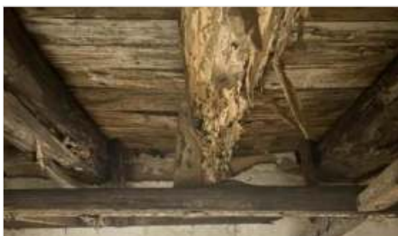
现象：木楼盖、木梁受潮、严重腐朽 判断：存在安全隐患
