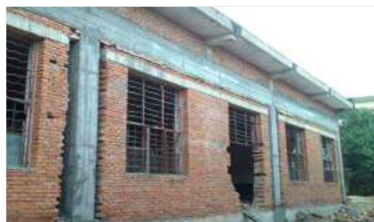
现象:违规墙改梁,拆改承重墙、增设框架柱梁 判断:存在安全隐患
