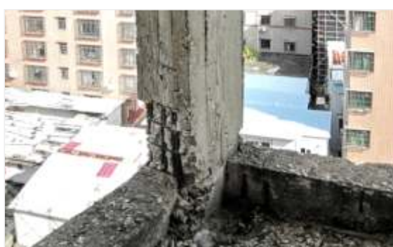
柱钢筋锈蚀、保护层脱落
