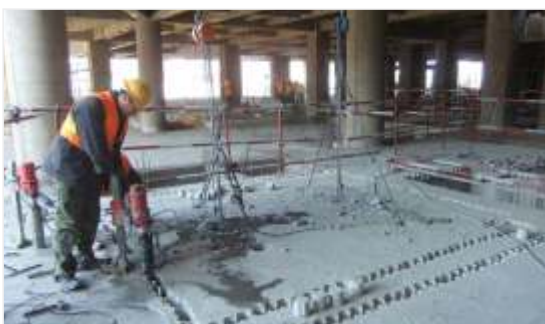
现象:违规切割混凝土楼板 判断:存在安全隐患
