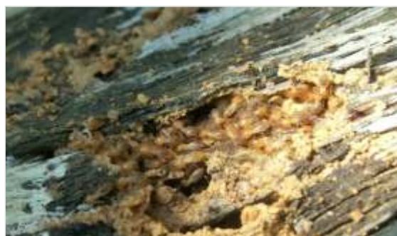
现象：承重木构件受虫蛀 判断：存在安全隐患
