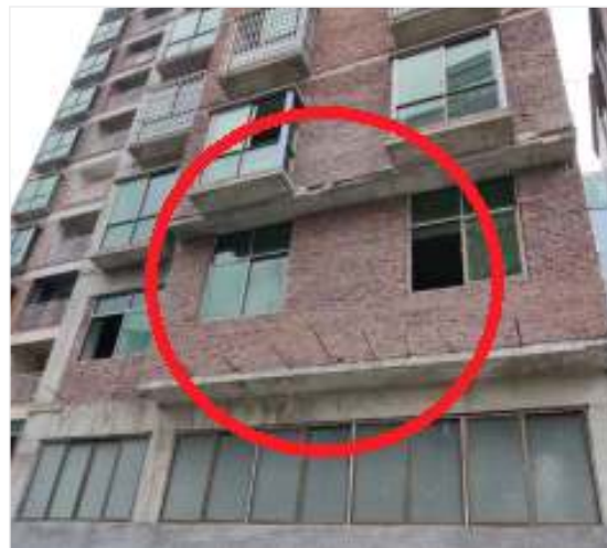
现象：违规在悬挑板上设置承重墙 判断：存在安全隐患
