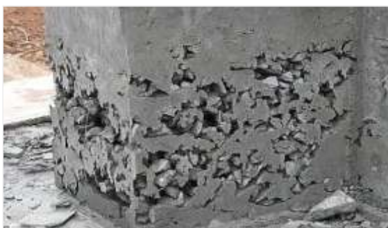
现象：混凝土构件外观有蜂窝、空洞或截面削弱 判断：存在安全隐患
