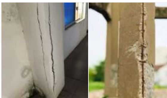
现象：柱构件顺筋开裂，打开保护层后钢筋锈蚀 判断：存在安全隐患
