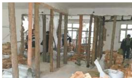
现象:违规野蛮装修改造 判断:存在安全隐患
