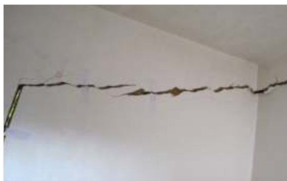
承重砖墙贯穿开裂
