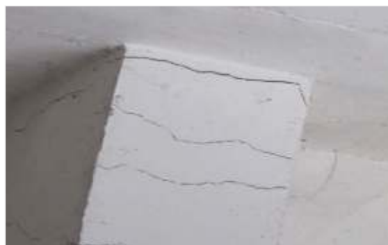
柱构件水平裂缝
